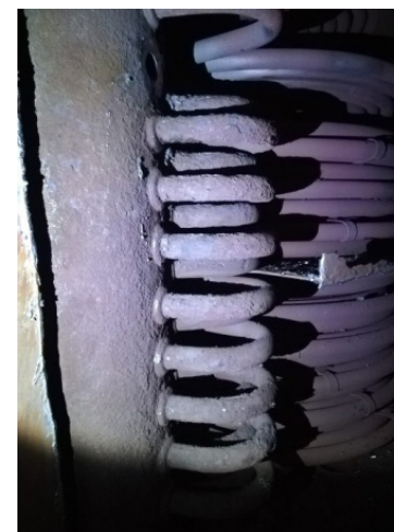
Рисунок 1 – Общий вид системы змеевиков ПВД после вскрытия
